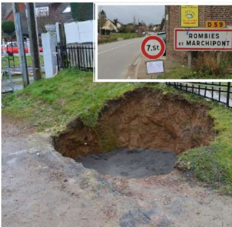
Le fameux trou au final rebouché avec quelque 400 mètres cube de béton. La restriction de circulation sur la RD59 (en médaillon) est on ne peut plus claire.
