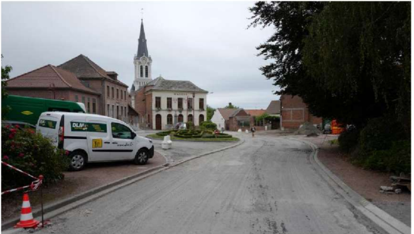
La rue de l'Église est en chantier pour plusieurs semaines. PHOTO PIERRE ROUANET
